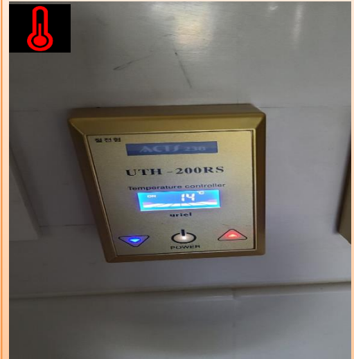
2동 난방 온도 조절기 사용방법: 실내온도보다 희망온도를 높게 설정하면 작동 됨.
