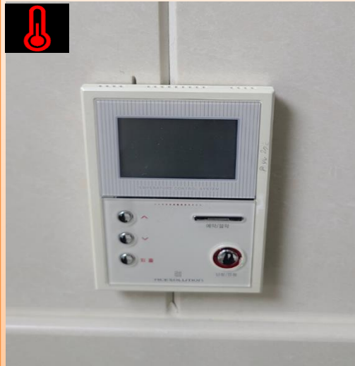
1동 난방 온도 조절기 사용방법: 실내온도 보다 희망온도 높게 설정하면 붉은 램프 들어옴.
